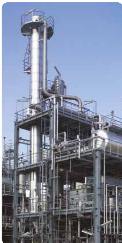
Impianti di trattamento chimico
