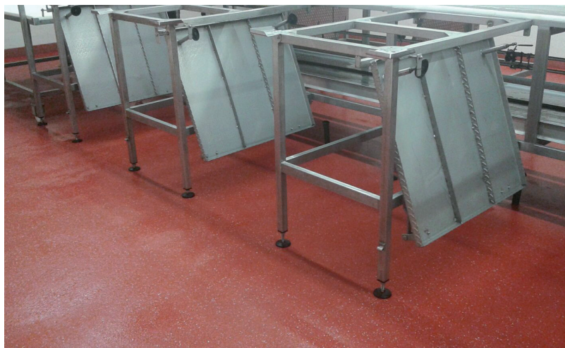
Pavimentazione Flowfresh dei locali di produzione del macello Friulcarni di Udine. Questo tipo di pavimentazione garantisce una superficie antimicrobica, confortevole ed ecologica, facilmente sanificabile, con riduzione del 99% della crescita batterica o delle muffe.
