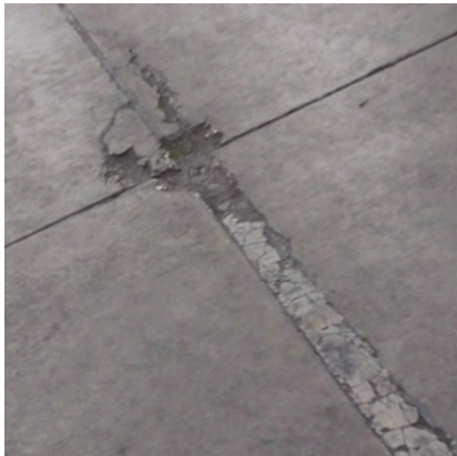
Poškození dilatačních spár
